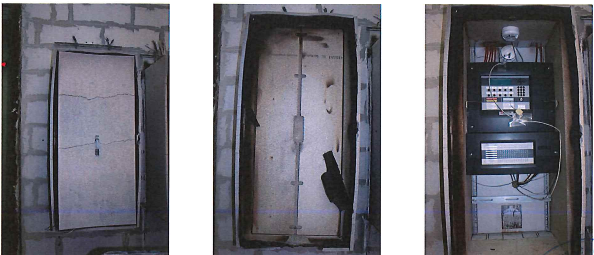
Abb. 1.3: Ansicht des Brandschutzgehäuses „EHL31.08234“ mit der Brandmeldezentrale „Notifier NF3000“ nach der Brandprüfung
