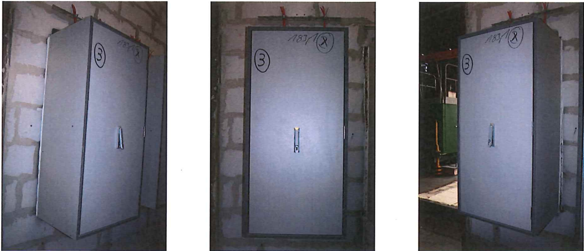
Abb. 1.1: Ansicht des Brandschutzgehäuses „EHL31.08234“ mit der Brandmeldezentrale „Notifier NF3000“ vor der Brandprüfung
